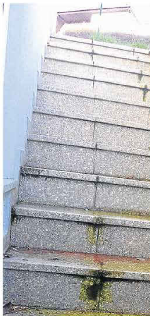
Bei der Erstbesichtigung zeigt sich das ganze Schadensbild an der Treppe.
