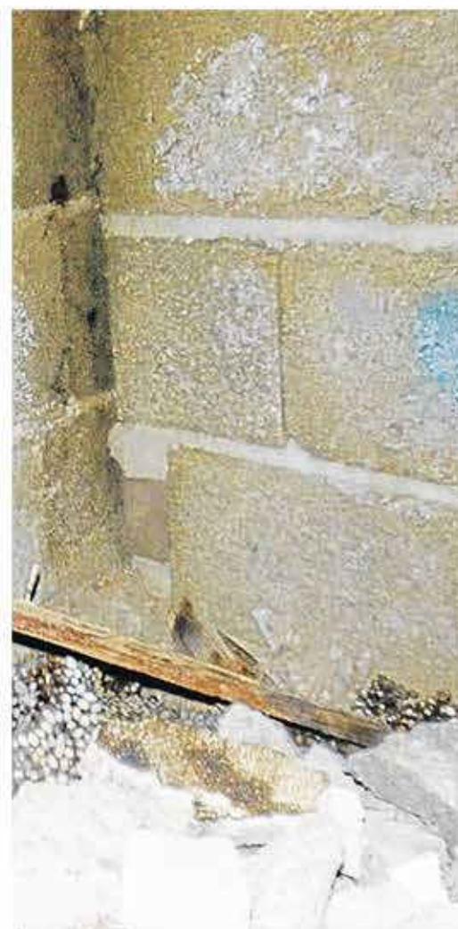
Ein Blick durch die Revision in den Hohlraum unter dem Treppenlauf zeigt die Feuchtigkeit.
