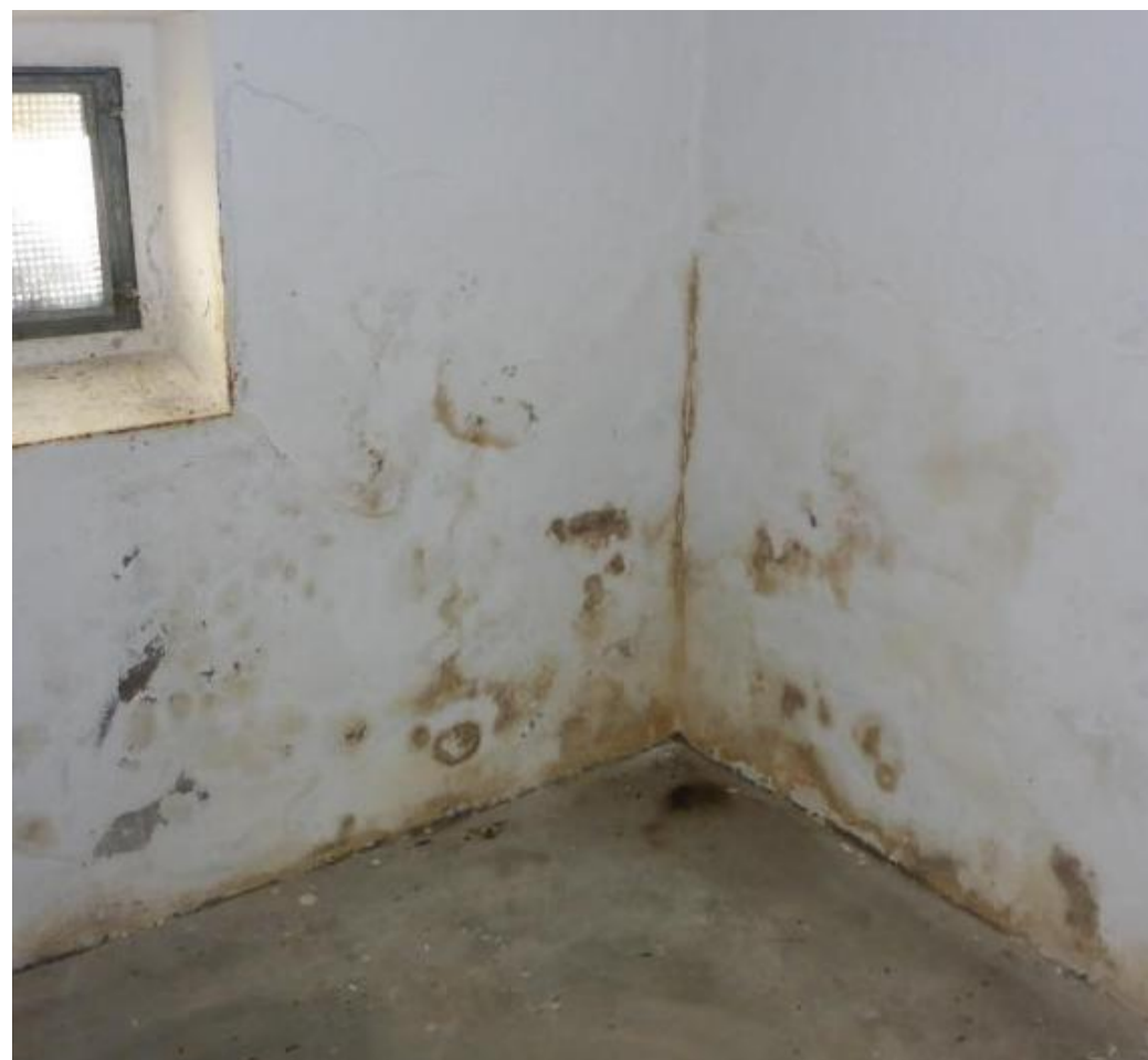
Schimmelbefall und Ausblühungen durch von außen eindringendes Wasser. Fotos: Georg Neu GmbH
