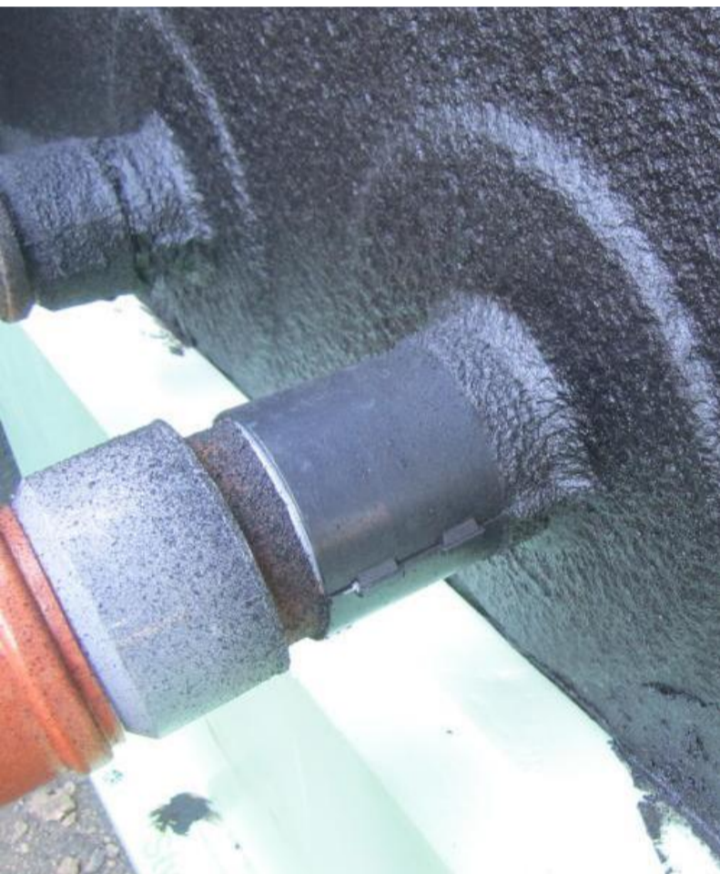
Fall 1: Im Rahmen der Gesamtinstandsetzung wurde bei der Kelleraußenabdichtung die Rohrflansche von außen mit kunststoffmodifizierten Bitumendickbeschichtungen eingeklebt.
