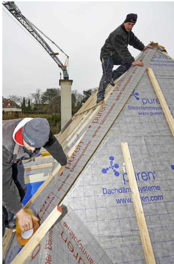
Schimmelprobleme entstehen meist durch Ausführungsfehler. Die nachträgliche Dämmung gehört daher in die Hände von Profis. Foto: djd/puren
