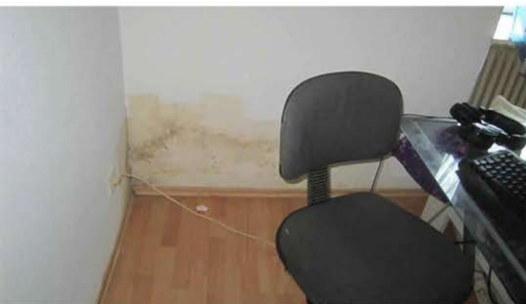
Die aufsteigende Feuchtigkeit in der Büroecke (Foto unten links) kann durch eine Horizontalsperre verhindert werden.
