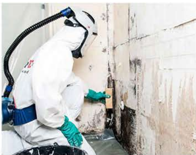
Schimmelpilze, die einen Fläche von mindestens einem halben Quadratmeter befallen, sollten von Profis entfernt werden.
