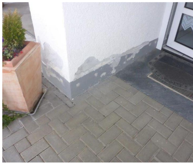
Im hier zitierten Fall löste sich die Fassadenfarbe von den Sockelflächen und es kam zu Putzabplatzungen. Die Oberputzschicht löste sich ebenfalls ab. Foto: Georg Neu
