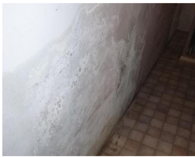
Putzausblühungen und Aussalungen auf der erdberührten Kellerinnenseite weisen auf eine nicht vorhandene oder beschädigte Kelleraußenabdichtung hin. Fotos: Georg Neu GmbH
