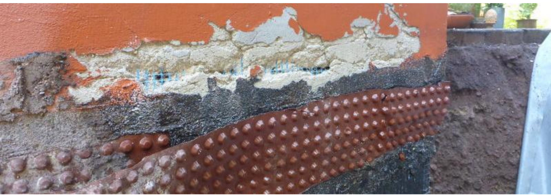
Solche Sockelschäden entstehen bei fehlenden Anschlussabdichtungen und ungeeigneten Sockelputzen.
